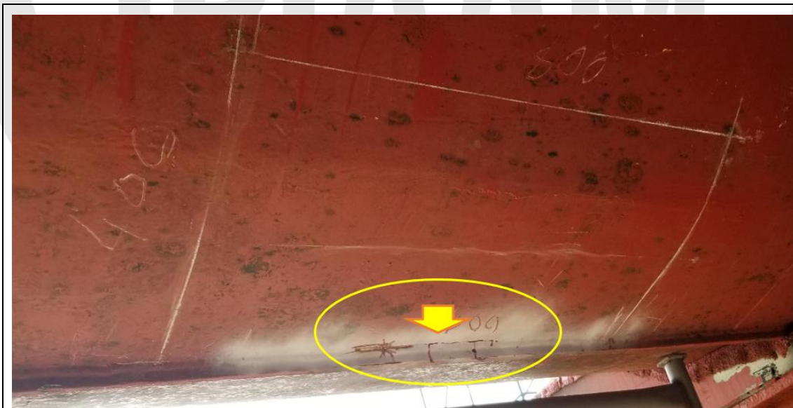
Figura 11: Fissura no casco, no fundo exterior do Tanque de Gasóleo de EB. Foto: CV-INTERILHAS.
